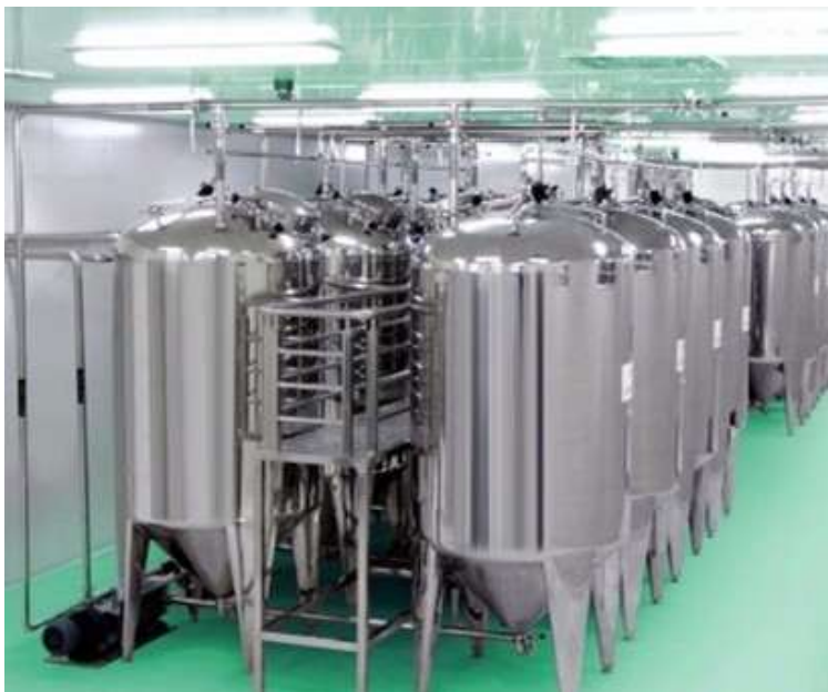
Cuve de Stockage
